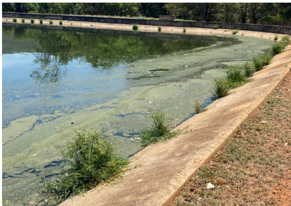
Figura 70 – Acúmulo de material na margem da lagoa
