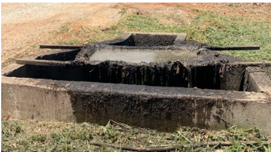
Figura 72 – Caixa de entrada dos efluentes de caminhão limpa-fossa na ETE
