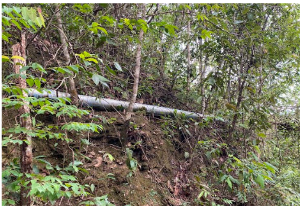
Figura 24 – Adutora de água bruta 03
