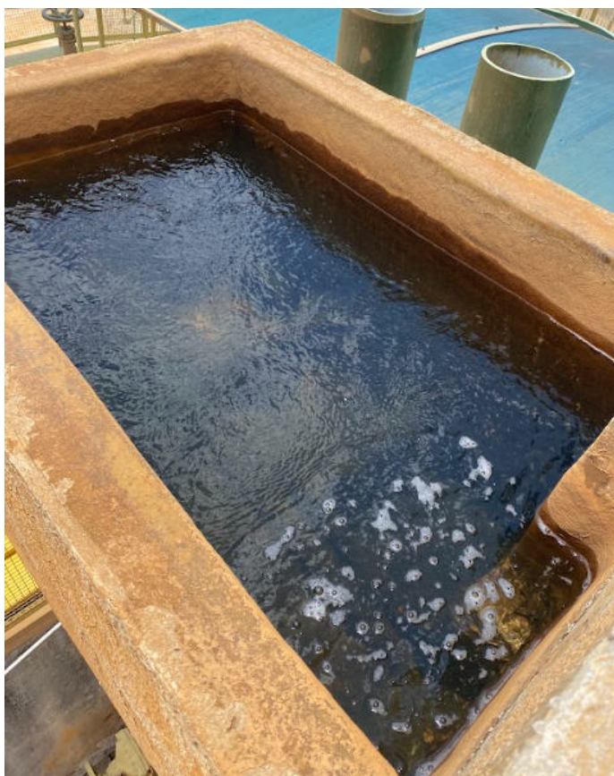
Figura 28 – Caixa de mistura ETA Andorinhas
