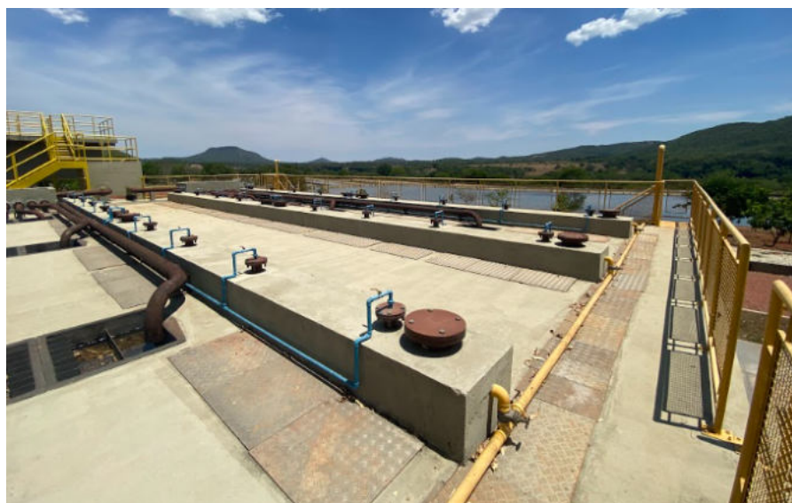
Figura 67 – Reator UASB da ETE
