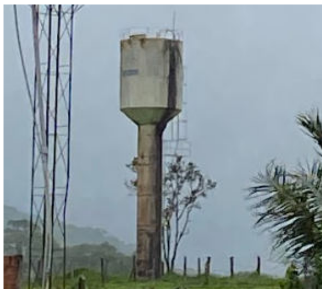
Figura 54 – Reservatório (Santo Antônio)
