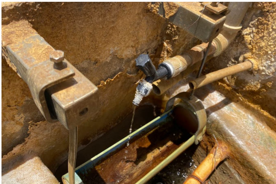
Figura 31 – Dosador de coagulante ETA Andorinhas
