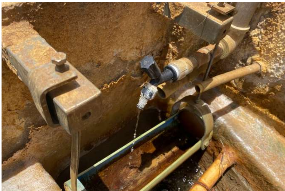
Figura 31 – Dosador de coagulante ETA Andorinhas
