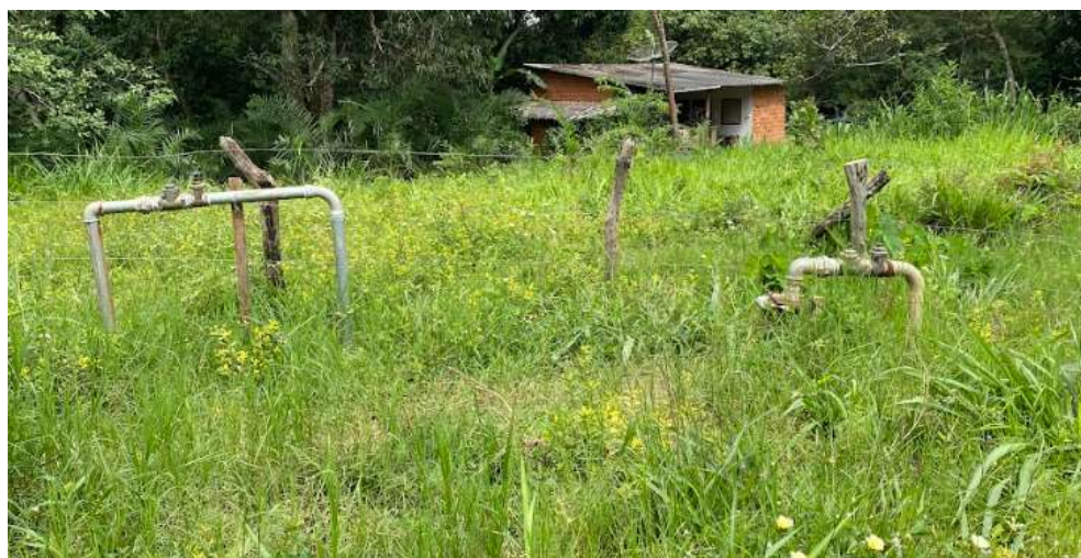
Figura 45 – Captações (Capela do Rio do Peixe)
