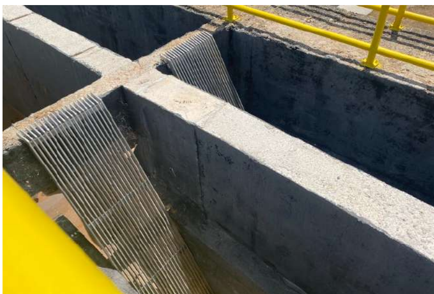
Figura 65 – Grade do desarenador da ETE (Sede)
