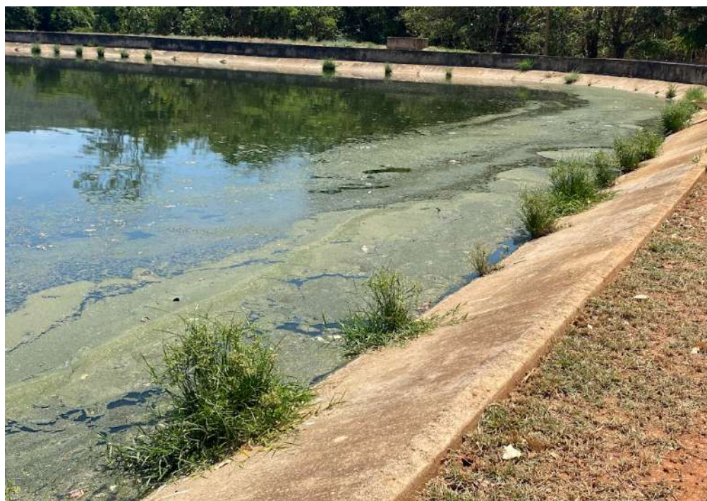
Figura 70 – Acúmulo de material na margem da lagoa
