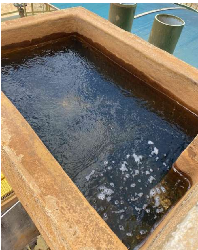
Figura 28 – Caixa de mistura ETA Andorinhas
