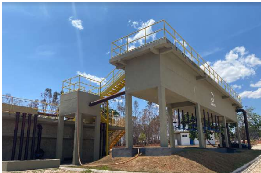
Figura 64 – Visão geral do desarenador da ETE (Sede)
