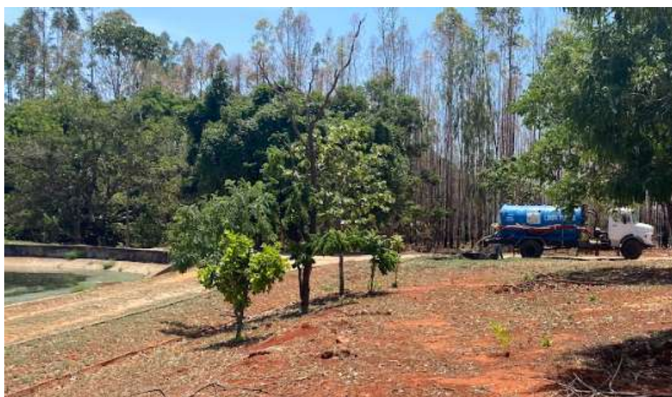
Figura 71 – Caminhão limpa-fossa despejando efluente na ETE
