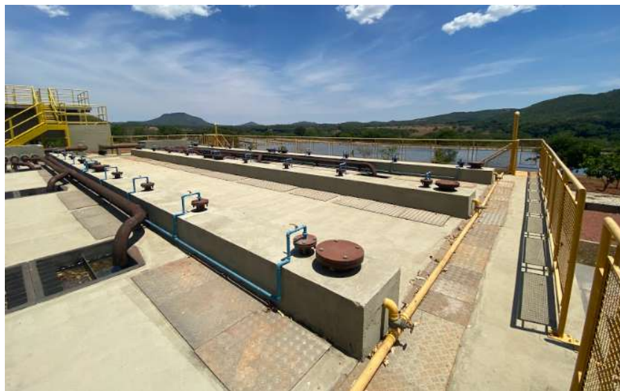
Figura 67 – Reator UASB da ETE
