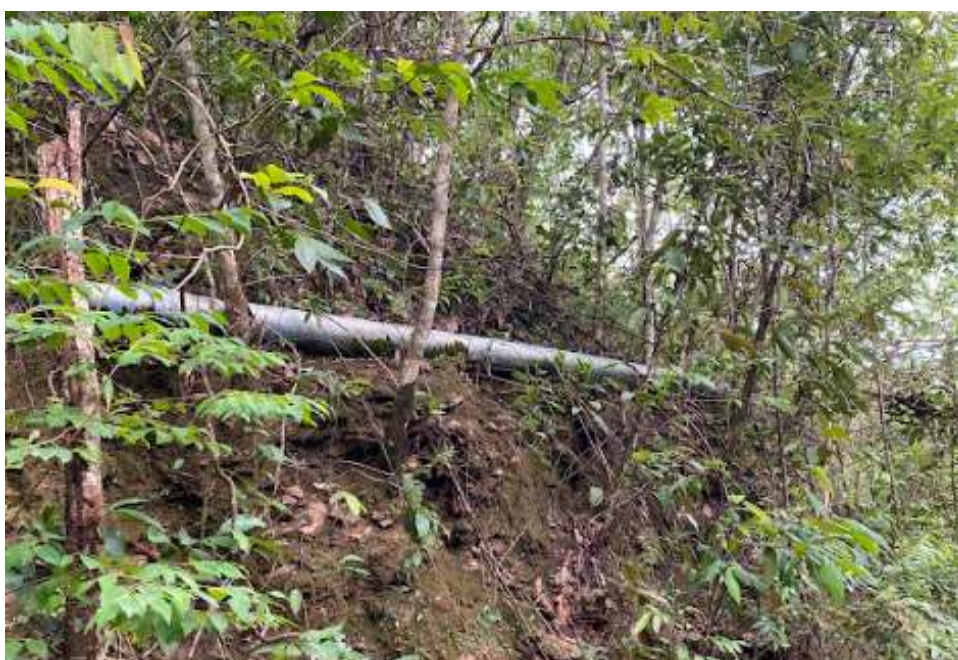
Figura 24 – Adutora de água bruta 03
