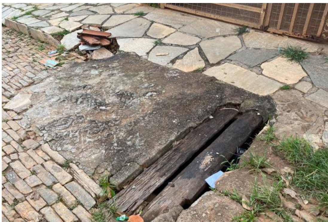
Figura 93 – Boca de lobo com grelha de madeira coberta por cimento
