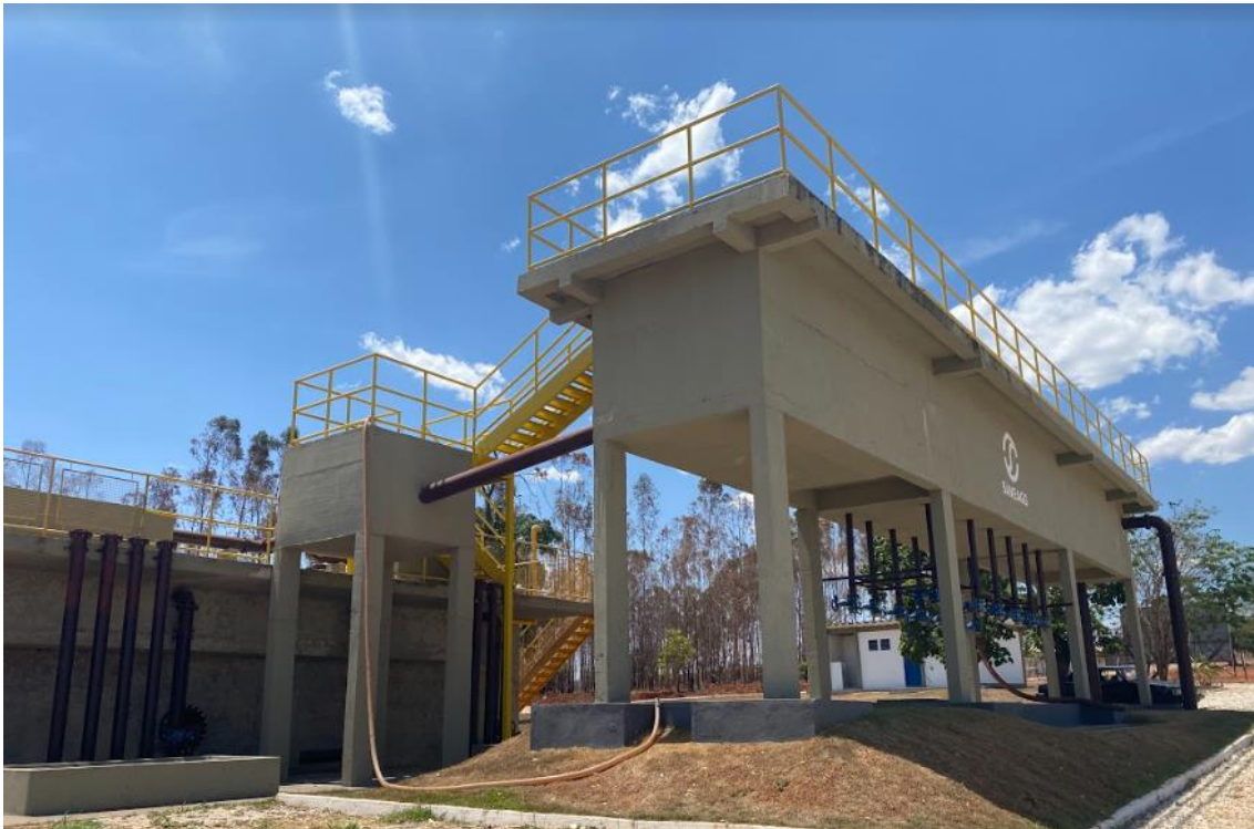
Figura 59 – Visão geral do desarenador da ETE de Pirenópolis
