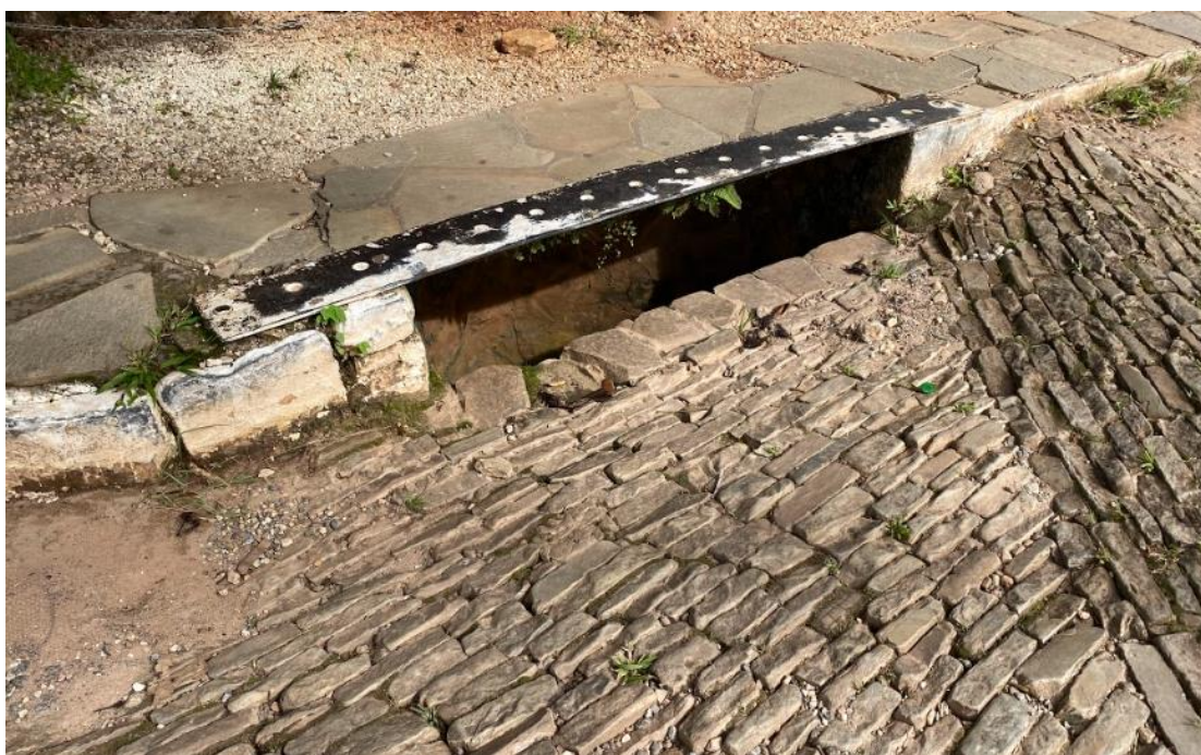
Figura 91 – Boca de lobo lateral
