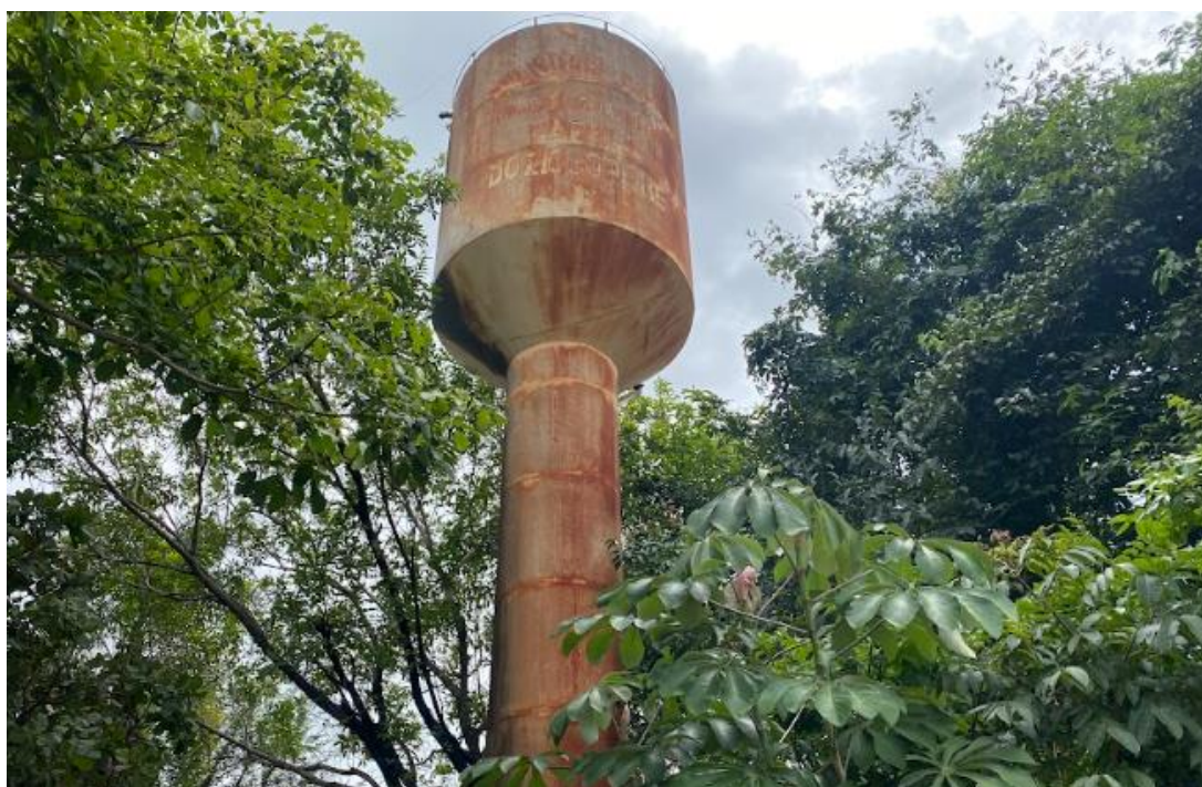
Figura 48 – Reservatório (Capela do Rio do Peixe)
