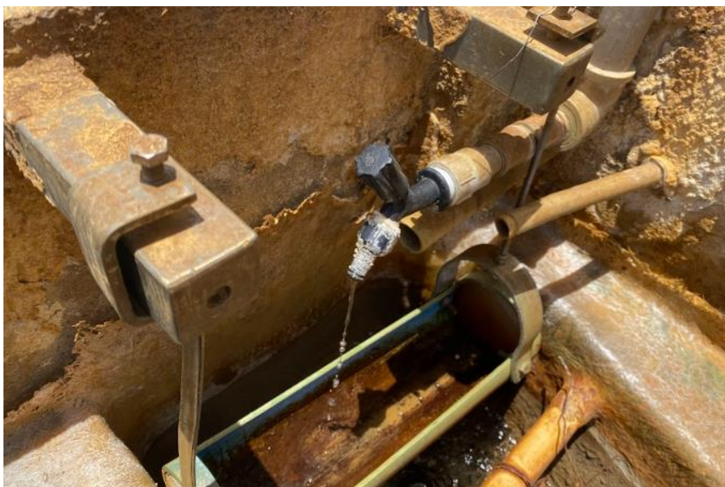
Figura 33 – Dosagem de coagulante ETA Andorinhas
