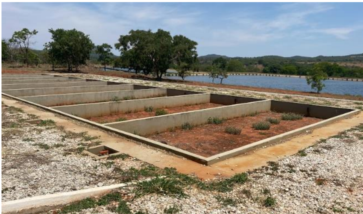
Figura 63 – Leito de secagem da ETE de Pirenópolis
