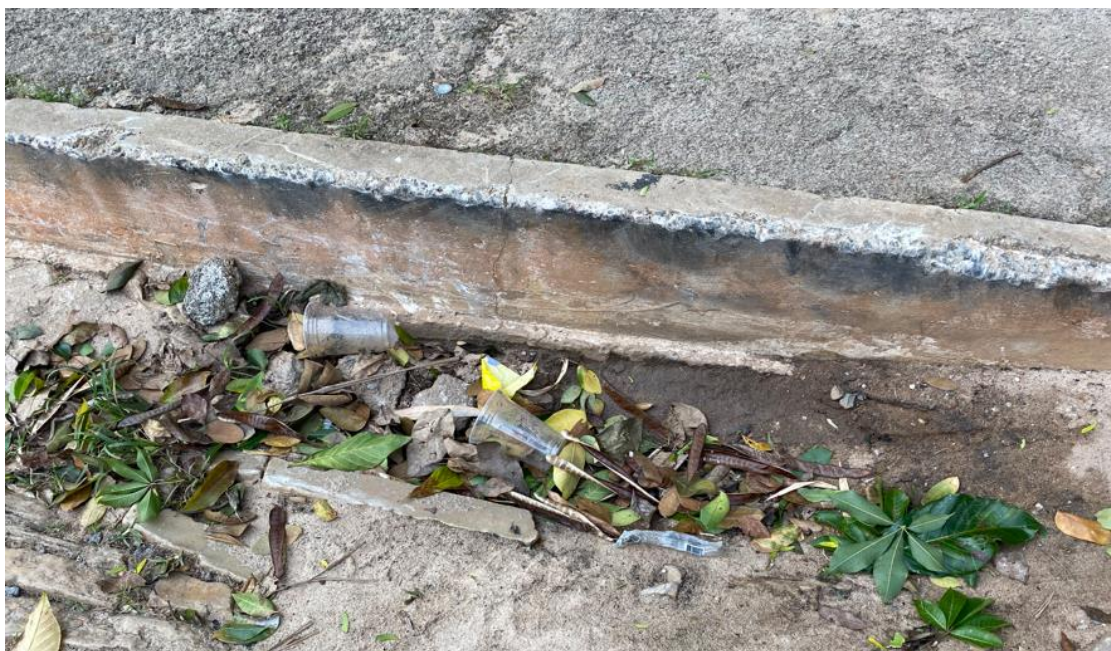
Figura 89 – Meio-fio com acúmulo de resíduos
