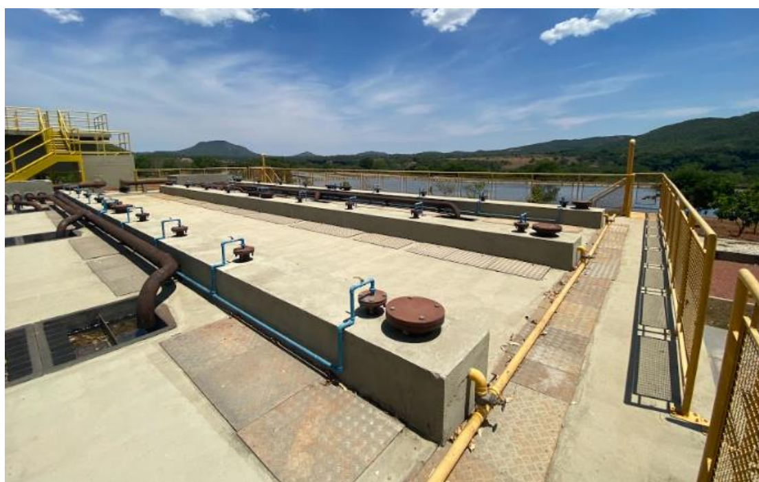
Figura 62 – Reator UASB da ETE de Pirenópolis
