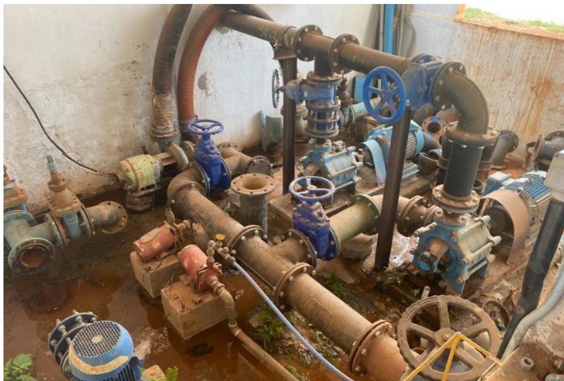
Figura 39 – EEAT Santa Bárbara (Sede)
