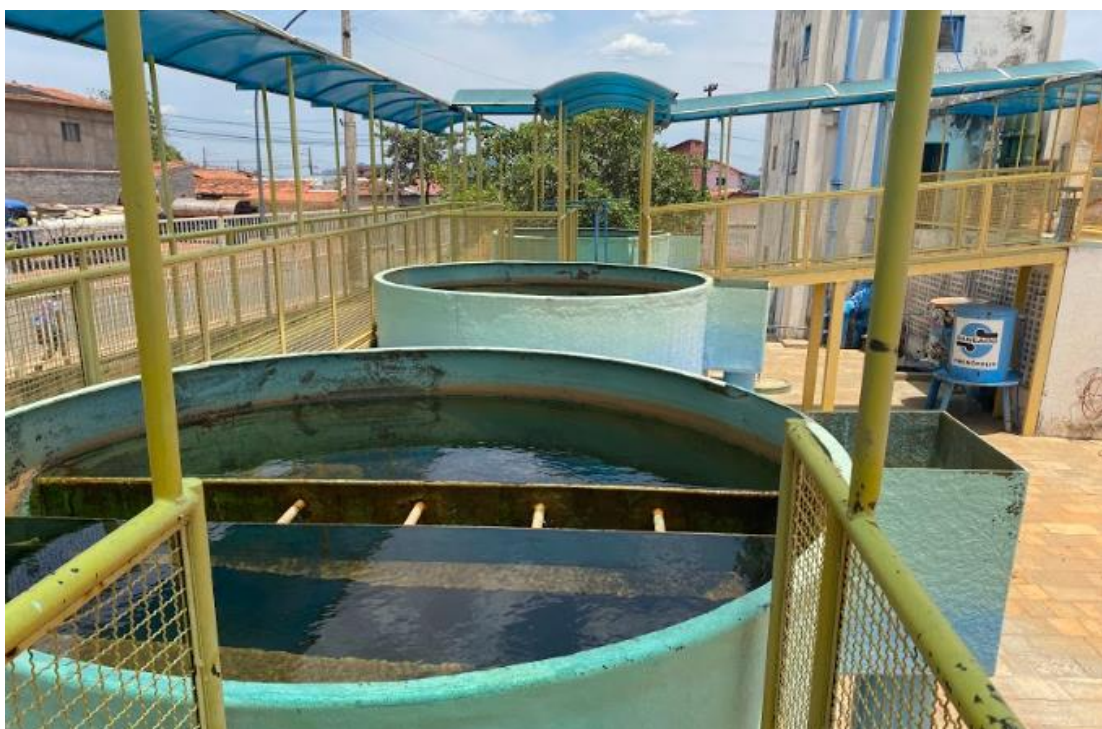
Figura 31 – Filtros russos ETA Andorinhas
