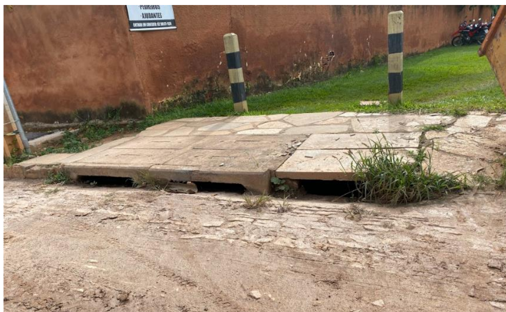
Figura 92 – Boca de lobo lateral múltipla
