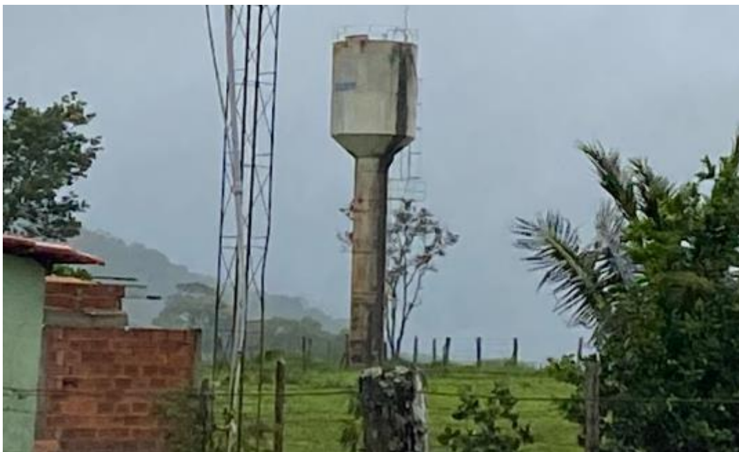
Figura 53 – Reservatório (Santo Antônio)
