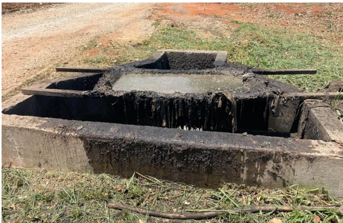
Figura 66 – Caixa de entrada dos efluentes na ETE de Pirenópolis
