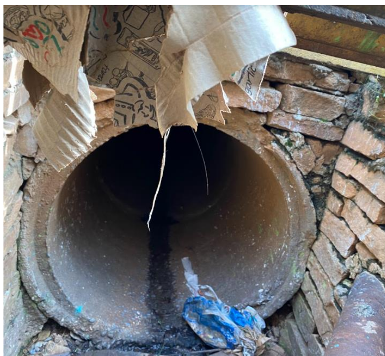
Figura 96 – Galeria de drenagem em manilha de concreto com acúmulo de resíduos
