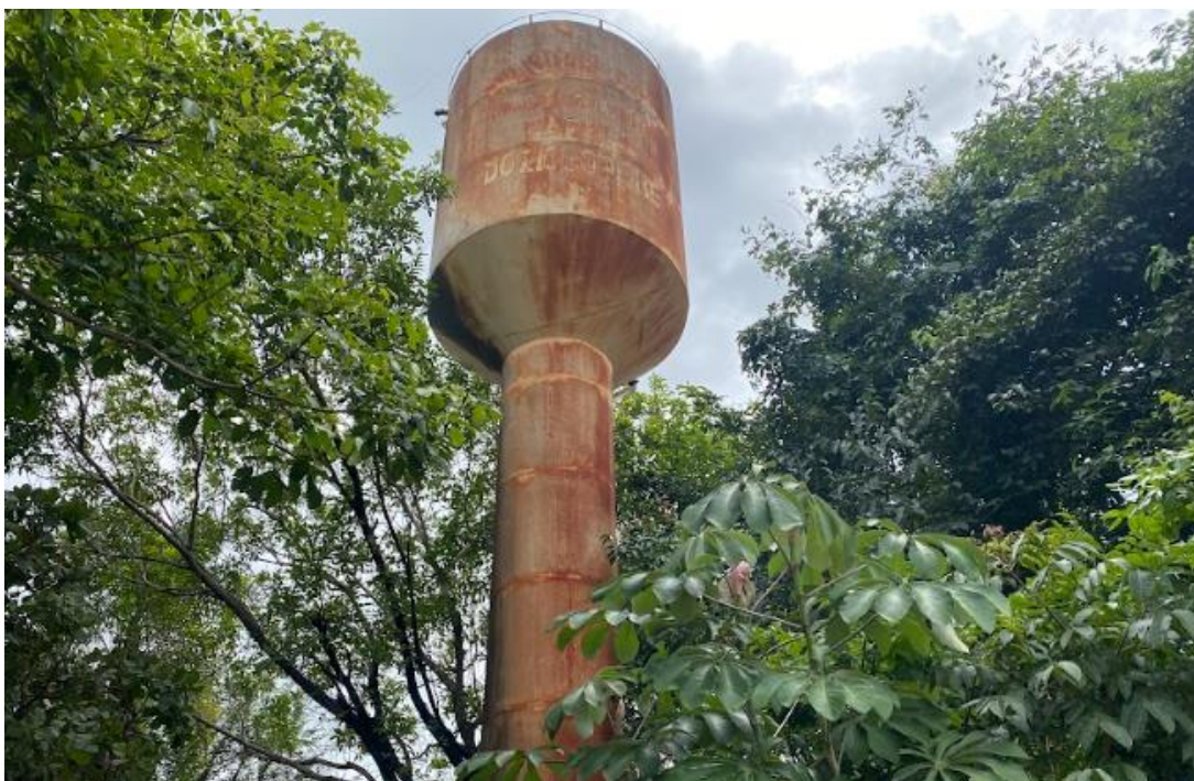
Figura 48 – Reservatório (Capela do Rio do Peixe)
