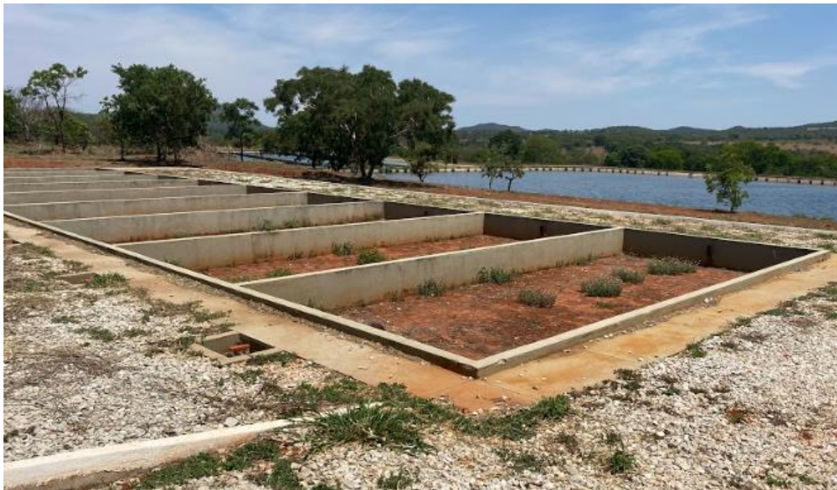
Figura 63 – Leito de secagem da ETE de Pirenópolis
