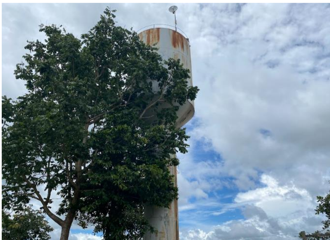
Figura 46 – Reservatório (Bom Jesus)
