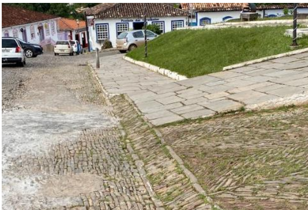
Figura 88 – Calçadas com áreas de infiltração (Centro Histórico)
