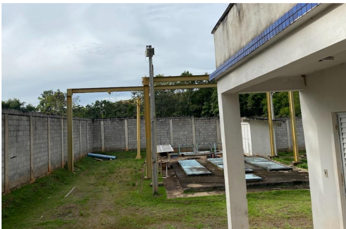
Figura 56 – Estação Elevatória de Esgoto (Sede)
