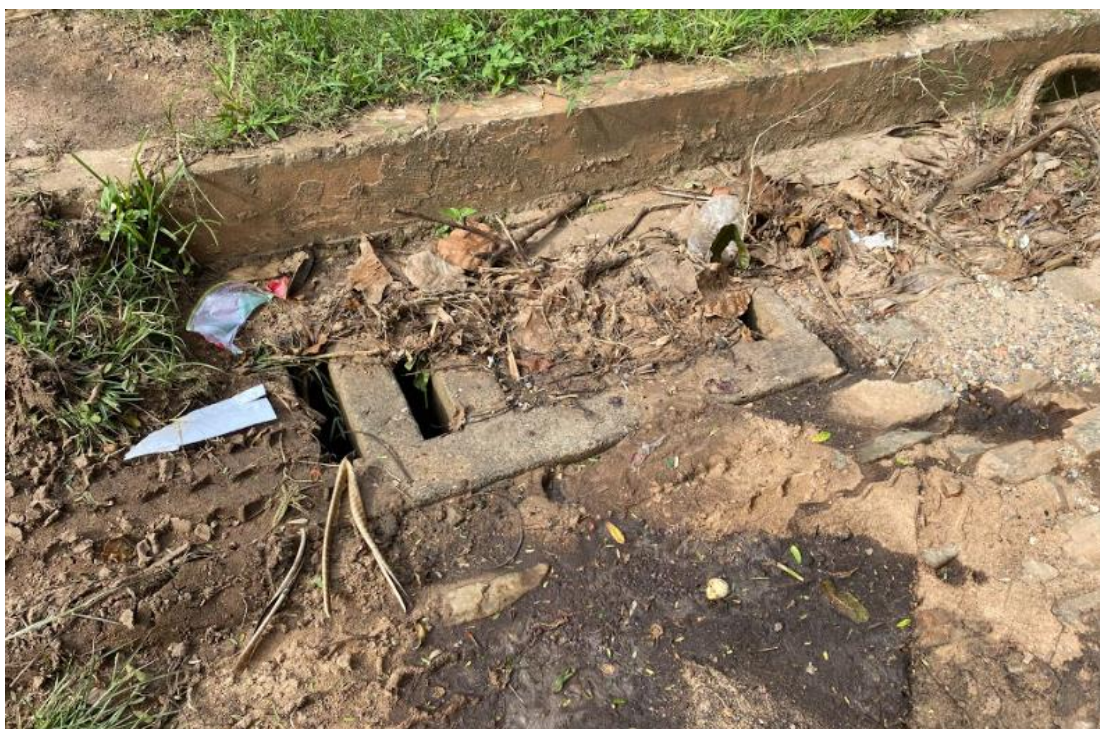
Figura 90 – Boca de lobo com grelha obstruída por sólidos retidos
