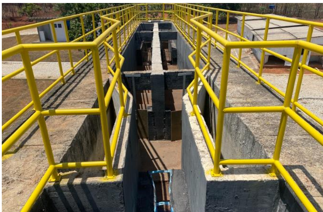
Figura 61 – Desarenador e calha Parshall
