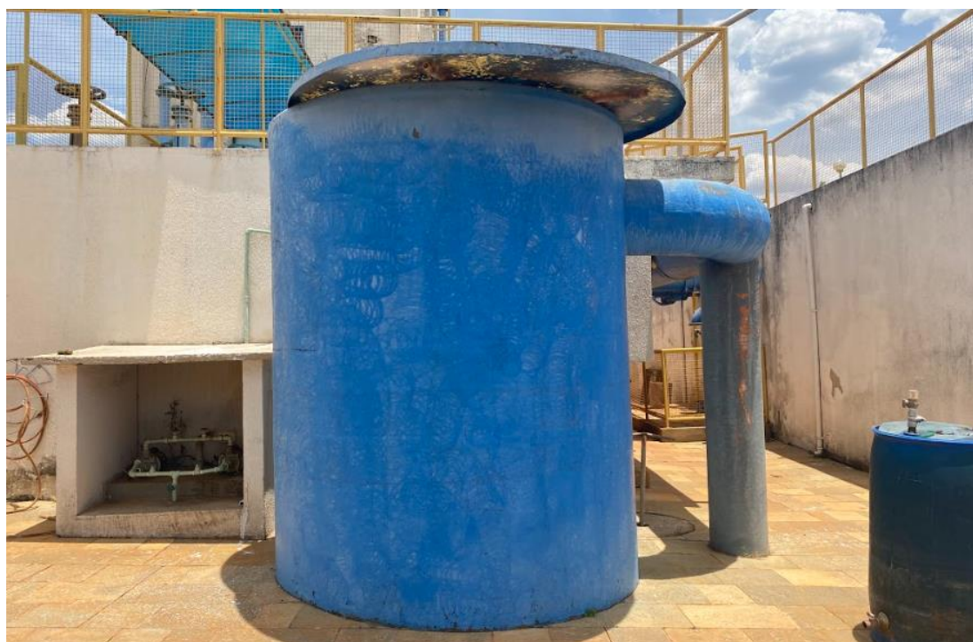
Figura 32 – Tanque de contato ETA Andorinhas
