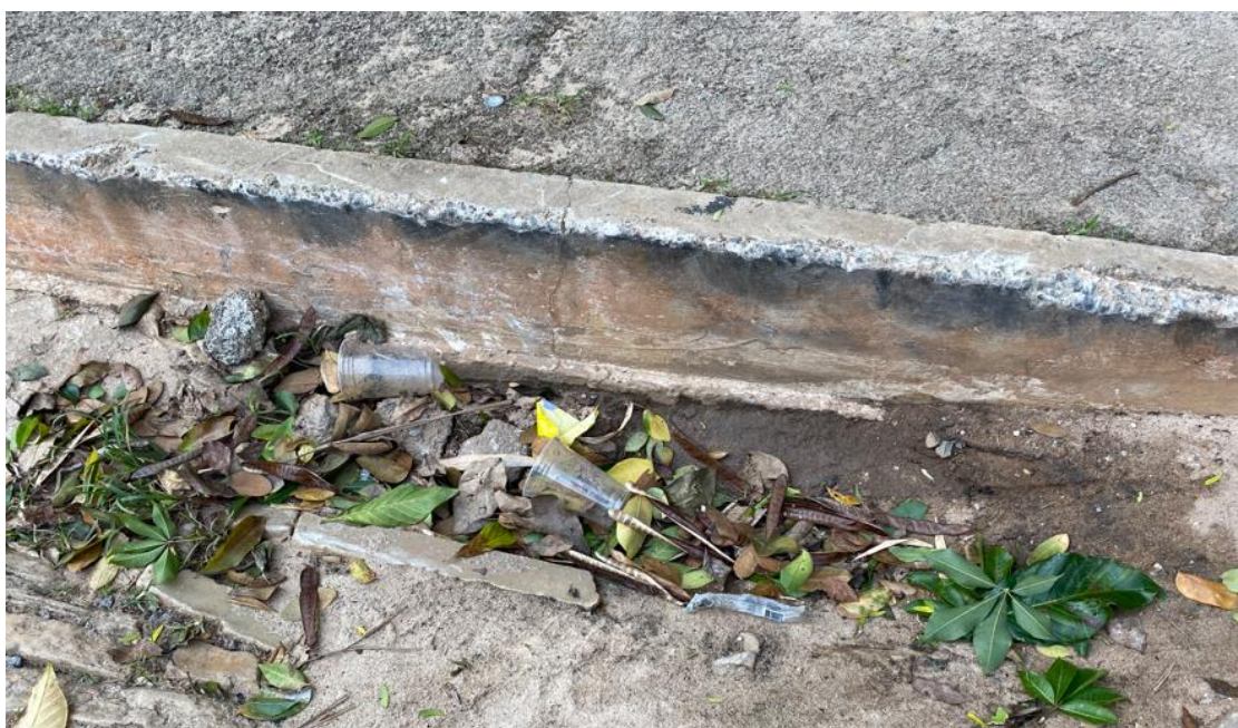
Figura 89 – Meio-fio com acúmulo de resíduos
