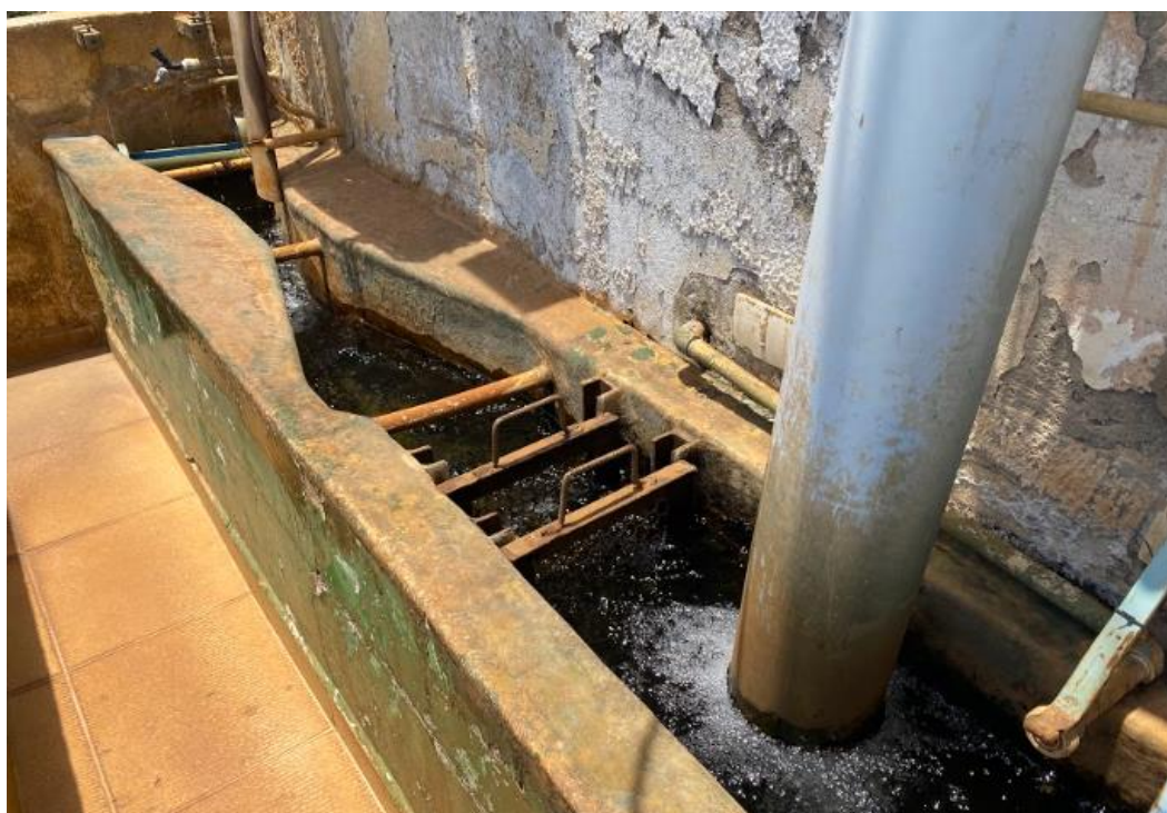
Figura 29 – Calha Parshall ETA Andorinhas
